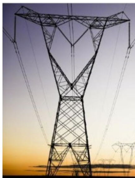
Рисунок 8: Самонесущая стальная решетчатая подвесная опора напряжением 500 кВ (одноконтурная) (источник: НЭСУ)
